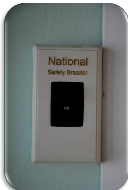
ภาพ 4.9 แสดงการโยก Breaker ในตำแหน่งเปิด( ON )
