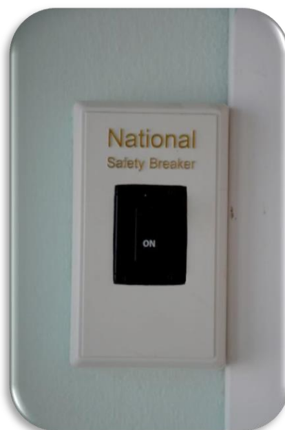
ภาพ 4.31 สวิตช์ On Breaker
