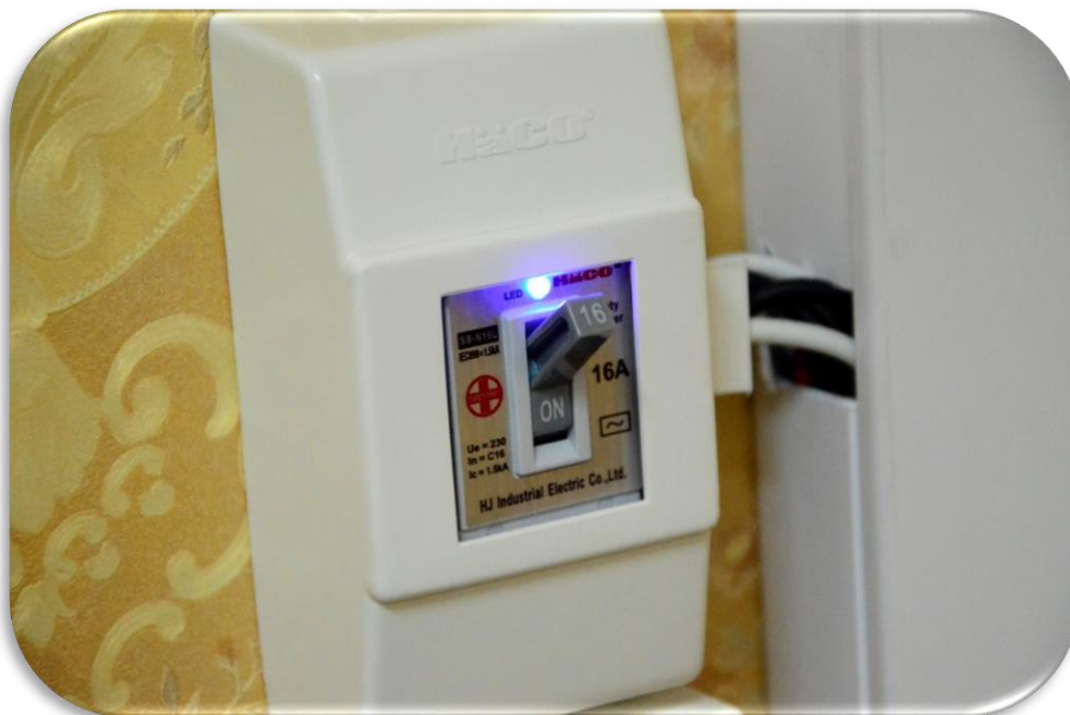
ภาพ 4.44 ภาพการเปิดเบรกเกอร์ (จะอยู่ข้างกระดานหน้าห้องเรียน) ไปในตำแหน่ง On ไฟสีฟ้าจะติด
