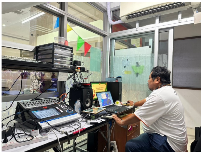
ภาพที่ 4.11 ตรวจสอบความพร้อมของเครื่องคอมพิวเตอร์ในห้องควบคุม
