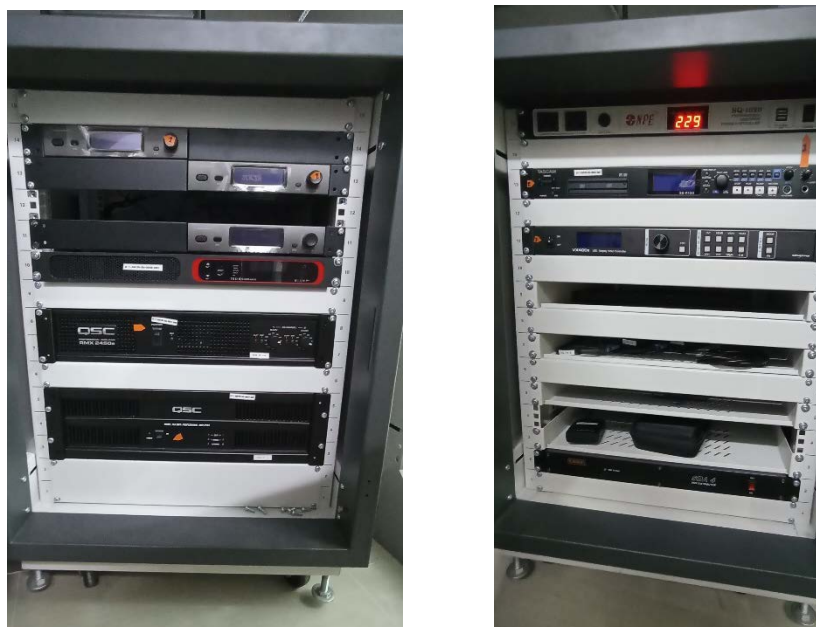
ภาพที่ 3.13 ตู้ควบคุมระบบภาพและเสียง
